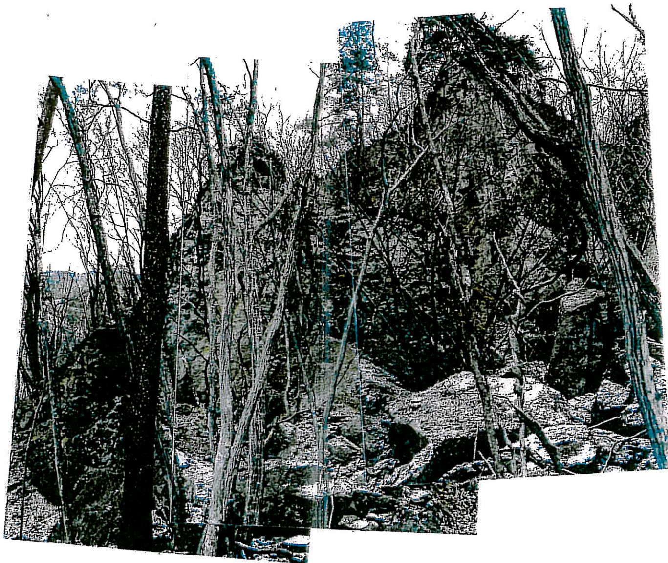
P-6 急崖部の突出部の状況 岩盤はゆるみが進行し、不安定化している。
