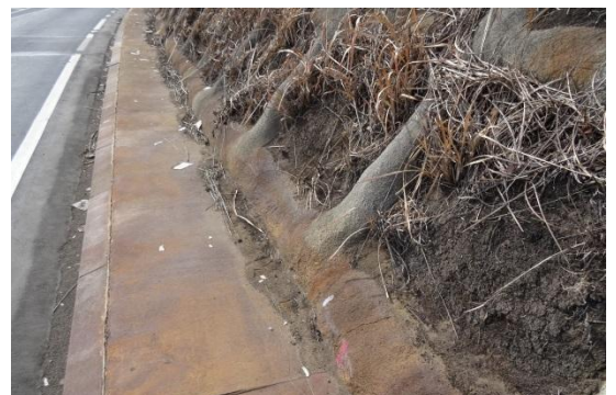
▲熱水変質を受けた地層から浸みだした酸性水により赤茶けた道路面との接触部
